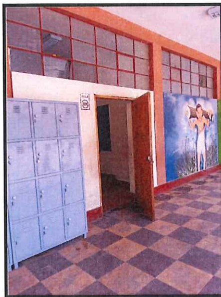
FOTOGRAFIA 22: Se observa el salón 8 del primer piso con sus cabinas las cuales requieren de un mantenimiento.
