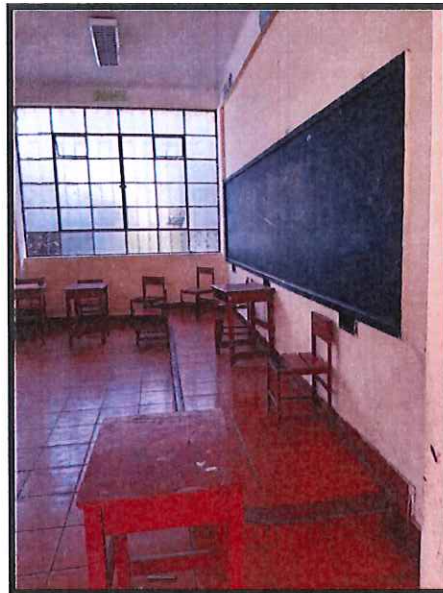
FOTOGRAFIA 14: Se puede observar el contra sòcalo del salón desgastado, así como el piso del salón con falta de limpieza y deteriorado.
